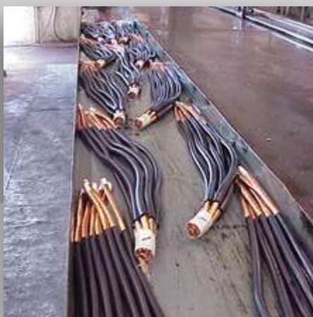
Horno de inducción Cables
